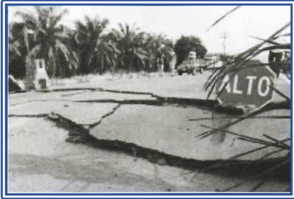
Fig. 5. Agrietamiento en la carretera Costanera ruta 34. Fuente: La Nación, 21 de noviembre del 2004.
